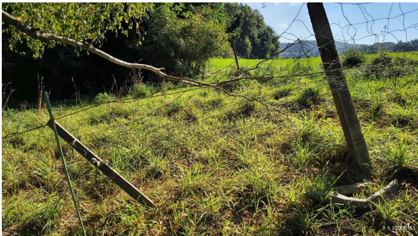
Foto č. 25 - špatný technický stav oplocení pastvin (9.9.2025)
