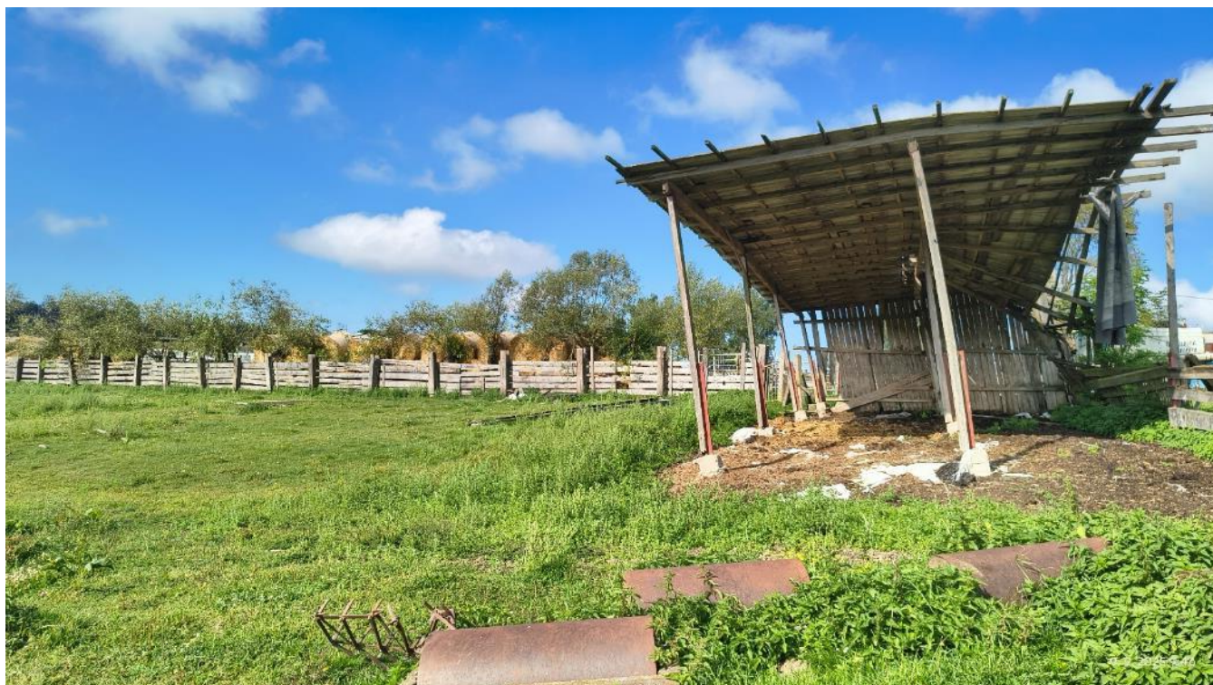
Foto č. 13 – druhé zimoviště ve špatném technickém stavu (9.9.2025)
